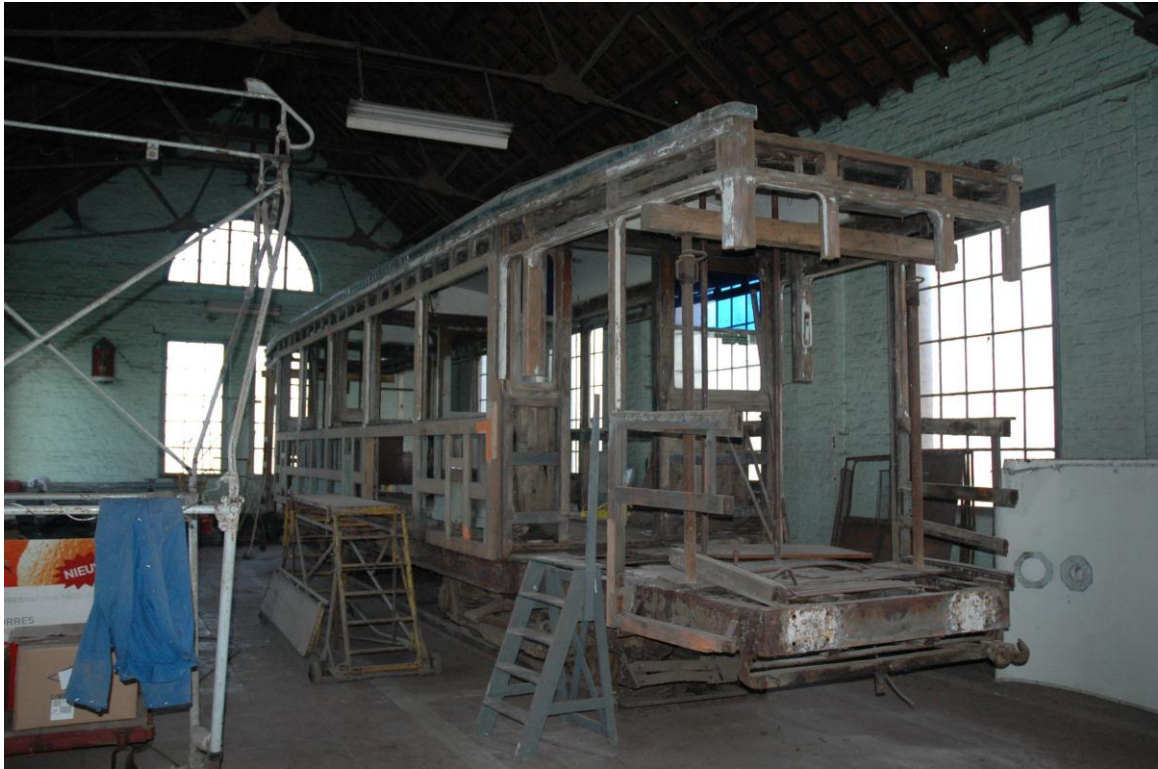
Herfst 2007 : de tram is grotendeels gedemonteerd en laat tal van rotte stukken zien, zowel in het houtwerk als in het metalen chassis !
